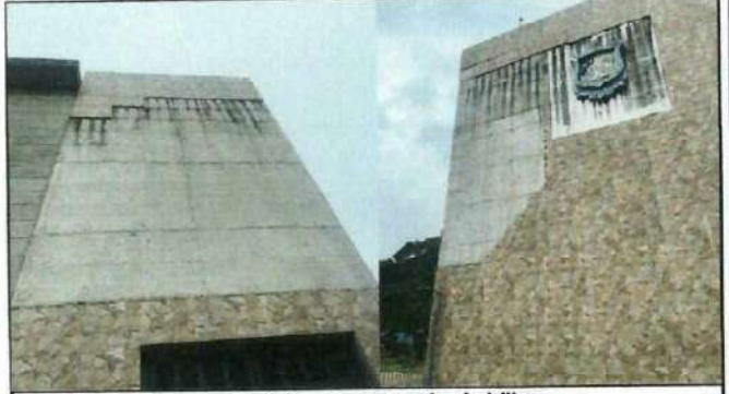
Foto 2: Fachada en mal estado, se cayeron los ladrillos
