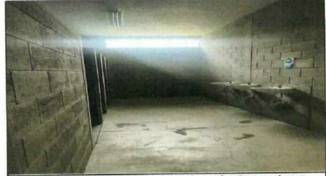
Foto 4: El sistema de agua para los sanitarios no funciona, por lo que necesita cambio de tubería
