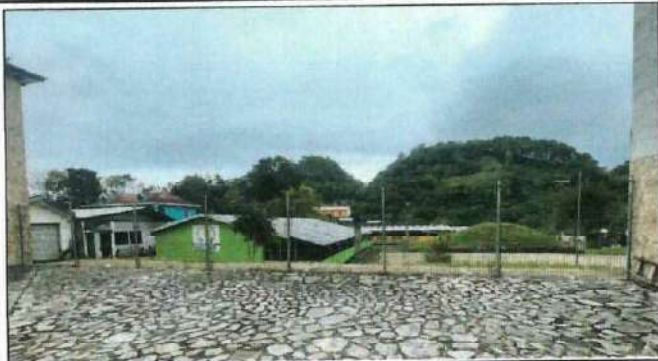
Foto 1: Falta de continuación de Entechado del Edificio Escolar
