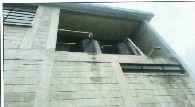
Foto 3: Tinacos ubicados en el segundo nivel, no envían agua hacia los sanitarios, lavamanos y migitorios
