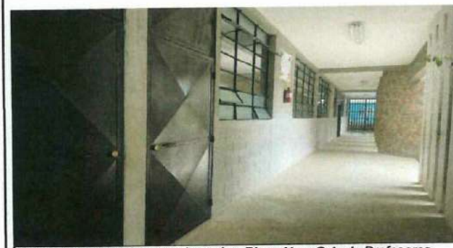
Foto 5: Necesidad de pintar las aulas, Dirección y Sala de Profesores, interior y exterior
